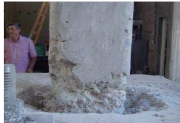
a) Hormigón eliminado en base de columnas.
